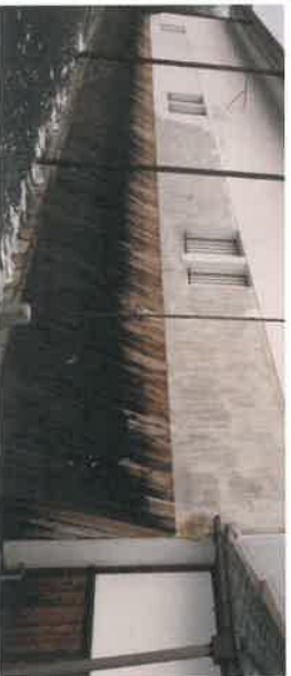
西山別院本堂西側(裏側)漆喰壁の剥離
